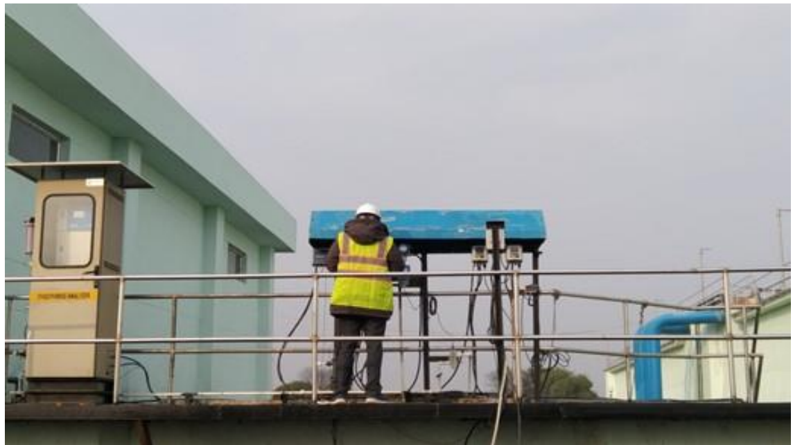
Analysers & Flow Meter
